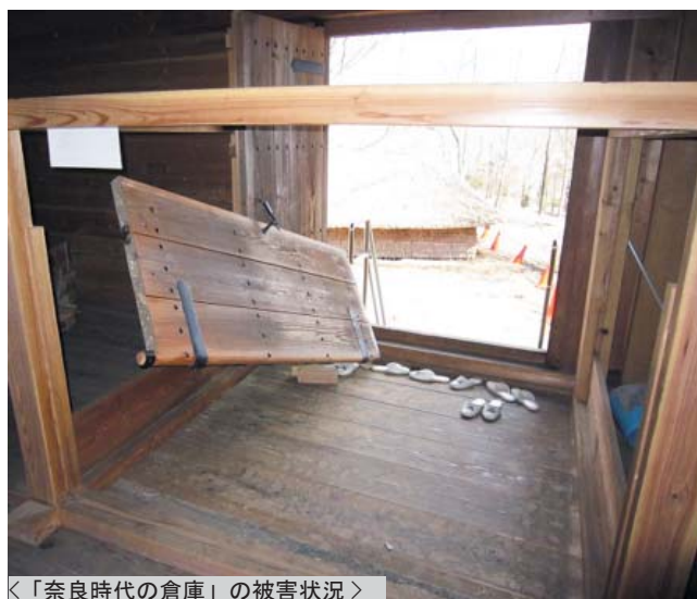
＜「奈良時代の倉庫」の被害状況＞
