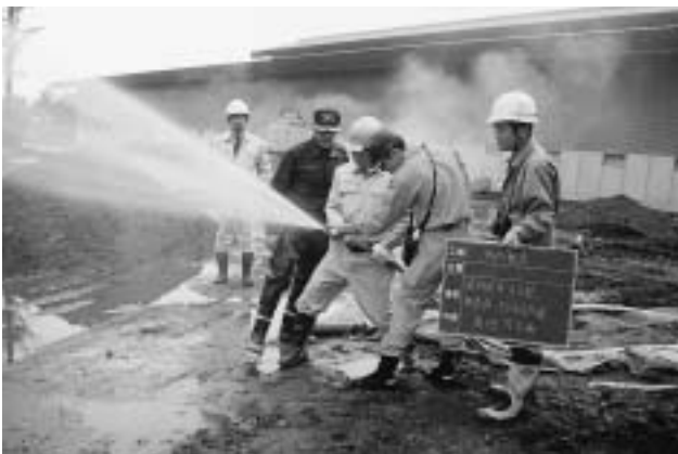
消火栓の消防検査
