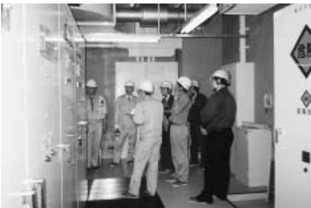
電気設備の検査
